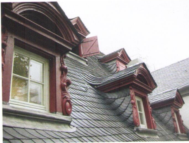
Fertige Dachlandschaft am Schängelplatz: Fenster in den genutzten Teilen, Klappläden im Dachbodenbereich.
